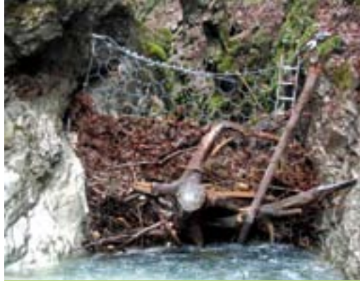
Abb. 6: Aktuelle Wildholzansammlung im Rückhalteraum der Seilsperre in hm 14,0 des Goiserer Weissenbaches.
