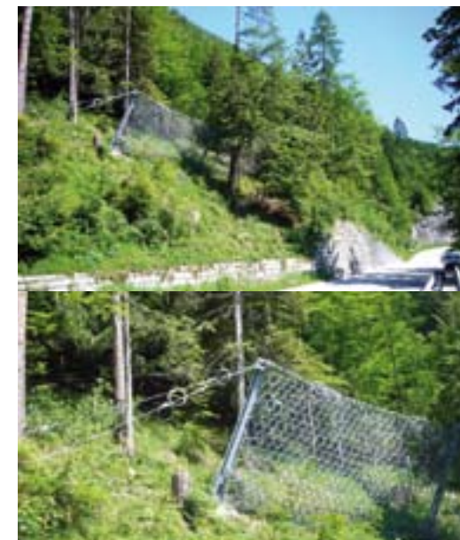
Abb. 5: 2007 fertiggestellte Steinschlagschutzverbauung des Typs „RX 300 Dimo“, System „GEOBRUGG“, mit einem Stützenabstand von 10,00 m und einer effektiven Verbauungshöhe von 4,00 m zum Schutz der stark frequentierten Hallstättersee-Landesstraße vor Steinschlag und Lawinen.
