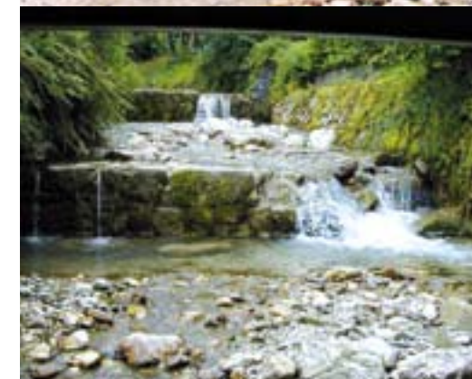
Abb. 8,9: Die beschädigten Grundswellen der Ortsregulierung bei hm 0,4 und hm 1,4 in der Gemeinde Steinbach a. A. nach dem Hochwasser vom 1. Juni 1996.
