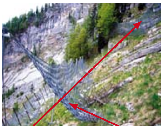
Abb. 6: Steinschlagschutzbarrieren vom Typ „CAN C1“ und „RXI-200“ mit einer Energieaufnahmekapazität von je 2.000 kJ zum Schutz der darunter errichteten Lawinenverbauung in Netzbauweise im Anbruchgebiet der Steingrabenlawine, Gemeinde Hallstatt.
