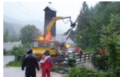
Abb. 1: Der Ortsteil Weissenbach, Gde. Bad Goisern, wurde im Zuge des Augusthochwassers 2002 weitflächig überflutet. Mit Holzgreifern wurde versucht das vorhandene Brückenprofil freizuhalten.
