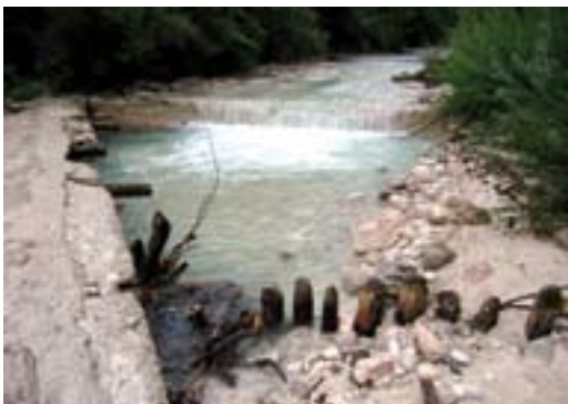
Abb. 8: Während dem Hochwasser vom 11.05.2005 stark beschädigte Grundschnelle an der Einmündung des Goiserer Weißenbaches in die Traun.
