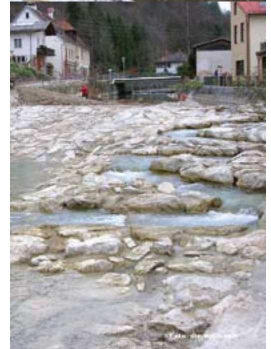
Abb. 4: Im linken Teil der Steinsohlrampe wurde ein mäandrierender Fischeaufstieg integriert. Lediglich am linken Rampenfuß kam es nach Hochwässern zu Verlandungen, welche bis in die untersten Tümpel reichten
