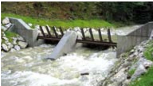
Abb. 9: Unholzrechen in der Wessenaurch, hm 32,0. Die Rechenelemente sind am Mitteljoch geklemmt und am Fußpunkt in einer durchlaufenden Führungsschiene fixiert. Durch Aufschwimmen des Holzteppichs wird im Hochwasserfall ein Bodenspalt für dosierten Geschiebetrieb freigegeben. Grobkomponenten sowie ankommendes Wildholz sollen zurückgehalten werden.
