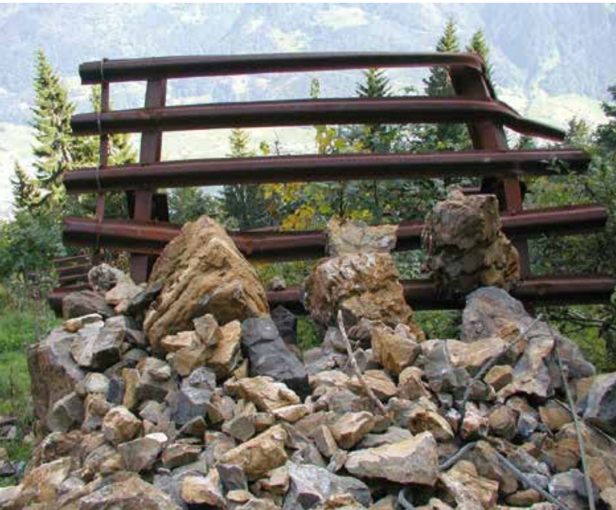
Abb. 8: Steinschlag zerstörte eine Steinmauer und beschädigte weiter unten Stahlschneebrücken (Foto: C. Rönna)
