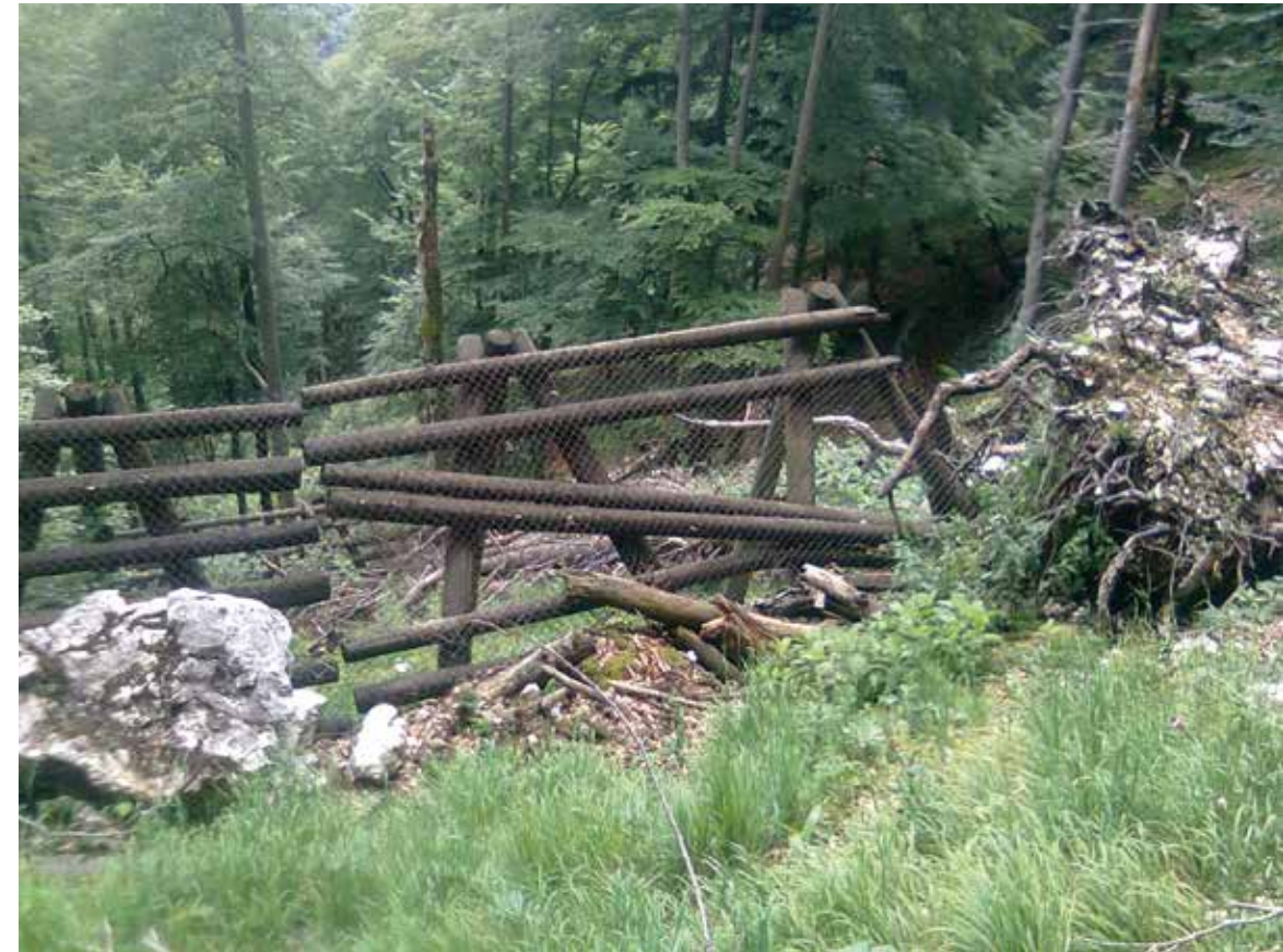
Abb. 10: Stark beschädigte Holzschneebrücken
