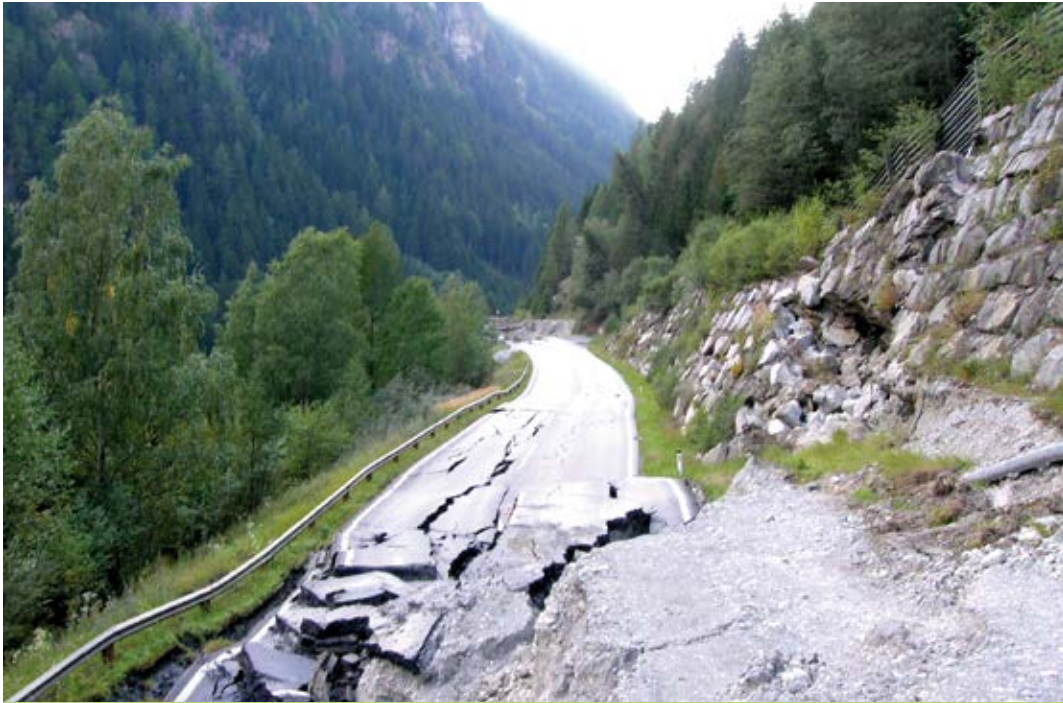
Abb. 2: Hangrutschung am Zintlwald an der B 316 zwischen Strengen und Pians (Quelle: Land Tirol)
