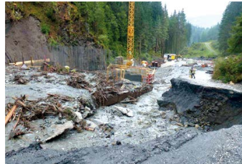
Abb. 7: Lorenzerbach, Grobfilterbauwerk nach Hochwasserereignis am 11.9.2012
