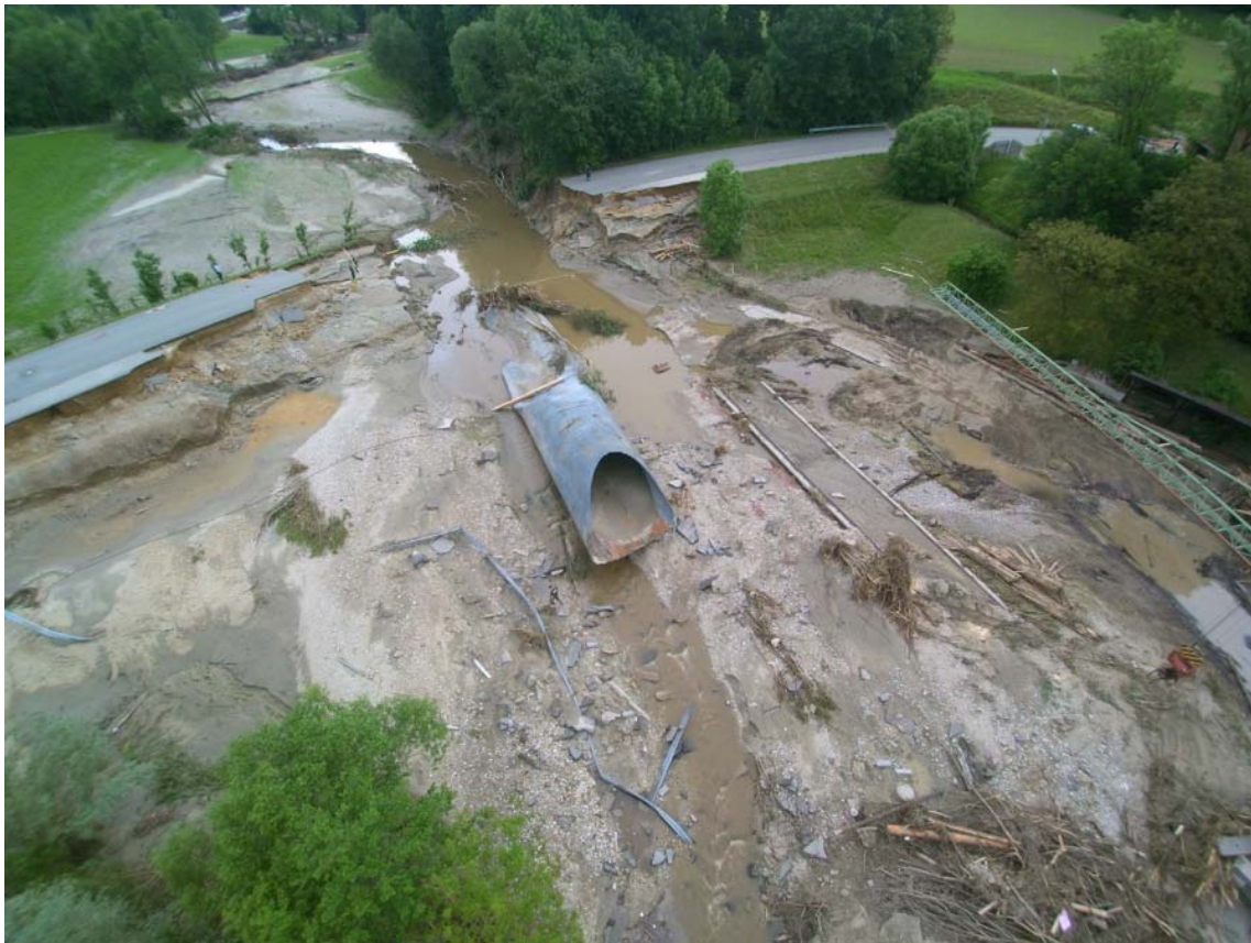
Abbildung 22: Der Rohrdurchlass bei der Schulstraße wurde beim Ereignis nicht verklaust (Foto: Gemeinde Simbach)
